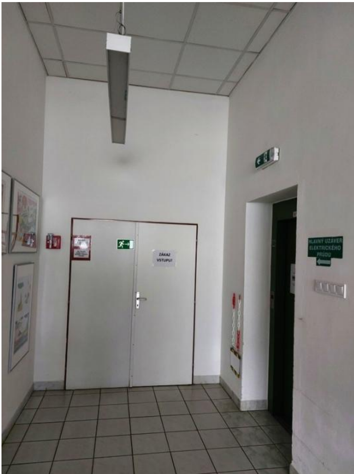
Obrázok 1: Vstup do podateľne – pohľad na sadrokartónovú priečku s dvojkrídlovými dverami určenými na demontáž a na príľahlé výtahové dvere.
